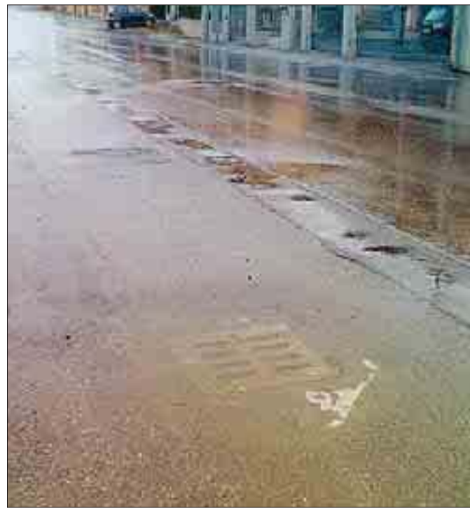
Manutenzione cercasi Via degli Artisti allagata (sopra) e un marciapiede di via Scania rotto
